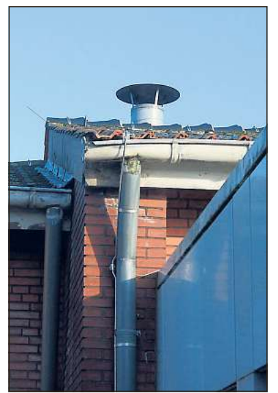
Gerade am ältesten Gebäudeteil der jetzigen Grundschule gibt es Sanierungsbedarf.
