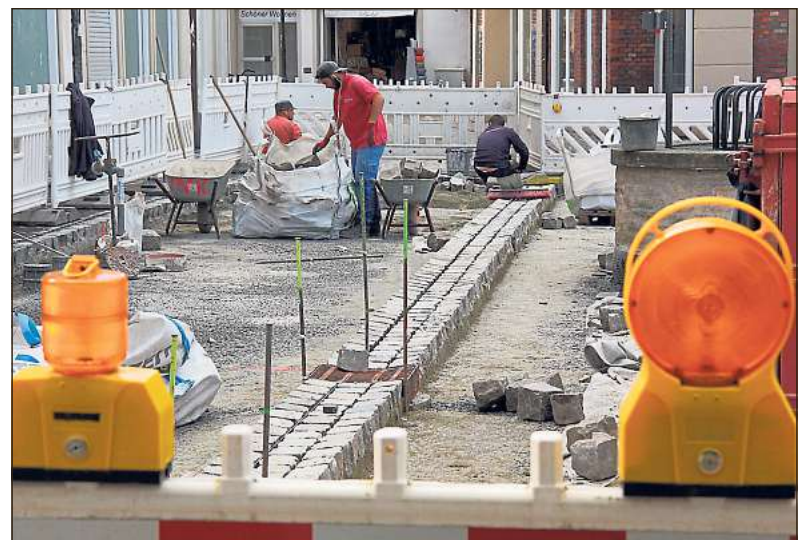
An der Südseite des Marktplatzes wird derzeit gepflastert. Die Straße „Im Ort“ ist für Fußgänger freigegeben, dafür ist für die nächsten gut zwei Wochen das Marktsträßchen voll gesperrt. Bild: Wild
